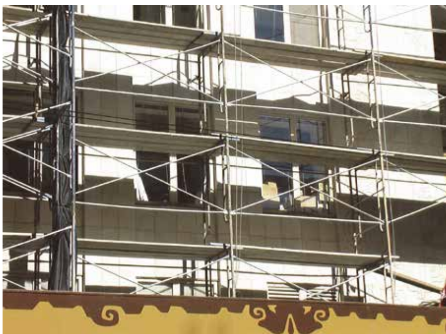
図 11 サンフランシスコにおける足場 (交さ筋かいの下に下棧が設置してある)
